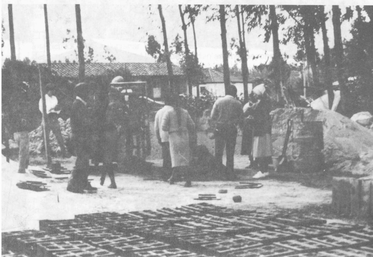
FIGURA 7.5 Una minga (tradicional trabajo comunitario en grupo) para hacer ladrillos de lodo compactado usando una máquina compactadora de ladrillos que había sido donada a la comunidad, Tabacundo, Provincia de Pichincha.
