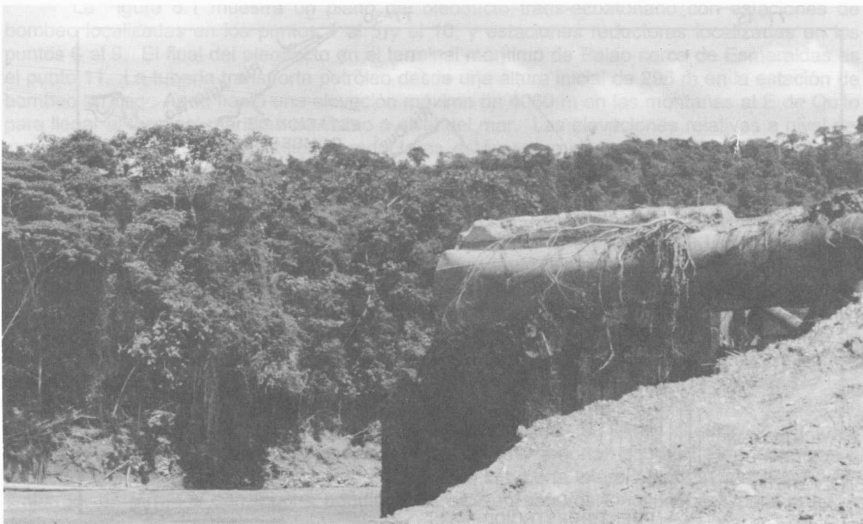
FIGURA 6.3 Oleoducto trans-ecuatoriano cortado por las inundaciones, orilla E del río Aguarico.
