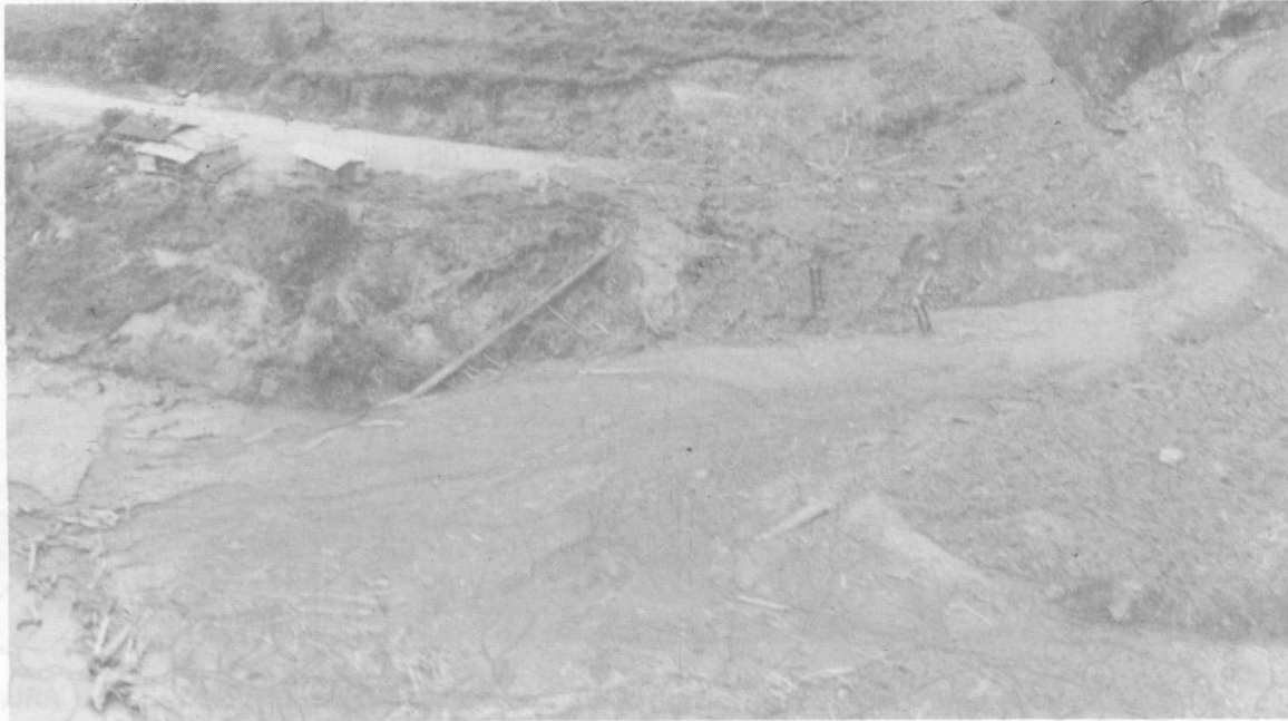
FIGURA 6.6 Oleoducto roto por un flujo de escombros que erosionó hasta 6 m por debajo de la tubería
