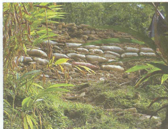
Fig. 20. Obras de mitigación construidas por los pobladores de la comunidad Sequilá I, para estabilizar rellenos de tierra.
