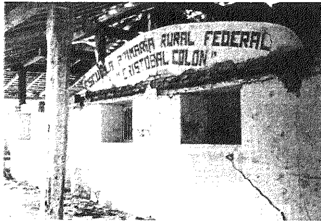
Figura 3.66 Daño en los muros de adobe y techo del edificio
