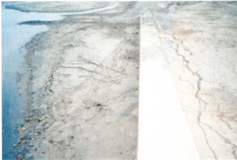
Foto 16.- Estribo sur del puente sobre el Río Sama: observe como el muro de contención está traccionado y fuera de la vertical. Igualmente, el banco de arena muestra claras evidencias de lateral spread y ocurrió eyección de arena por dos cráteres al pie del muro.
