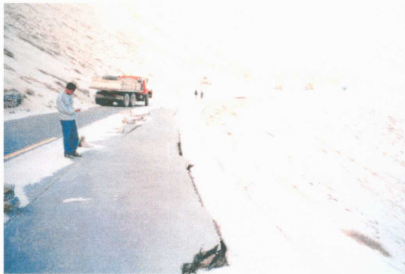
Foto 1.- Caída de depósitos eólicos en cortes de la carretera Panamericana sur, entre Atico y Ocoña, en fase de remoción después de sismo secundario (05/07/2001). Obsérvese también falla del muro de contención.
