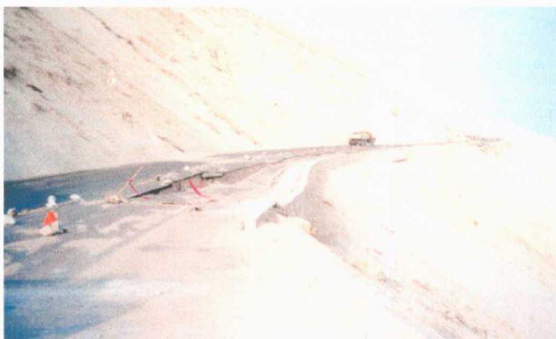
Foto 2.- Colapso de la calzada por falla del terraplén de relleno de la carretera Panamericana sur, afectando muros de contención, en sectores de arenas eólicas no consolidadas.
