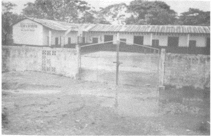
En la escuela César A. Sotomayor de Vines - Los Ríos, se requiere construir una zanja perimetral para conducir las aguas hacia una zona mas baja
